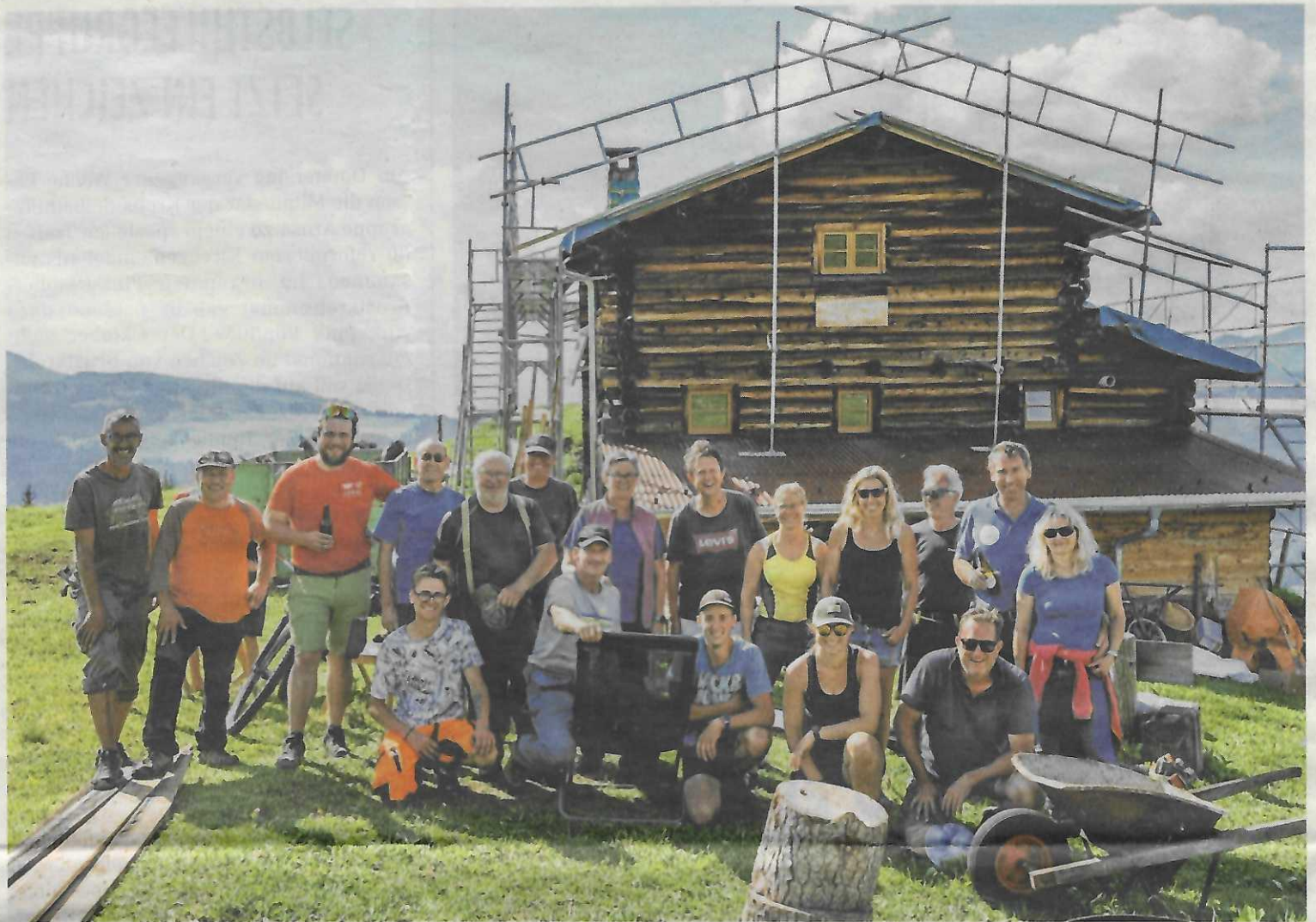
Helferinnen und Helfer aus allen Generationen packten bei der Dacherneuerung mit an.
